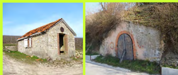
Loge très dégradée Entrée de cave encastrée dans la pente Des loges et des petits pavillons ponctuent l'espace du vignoble.
