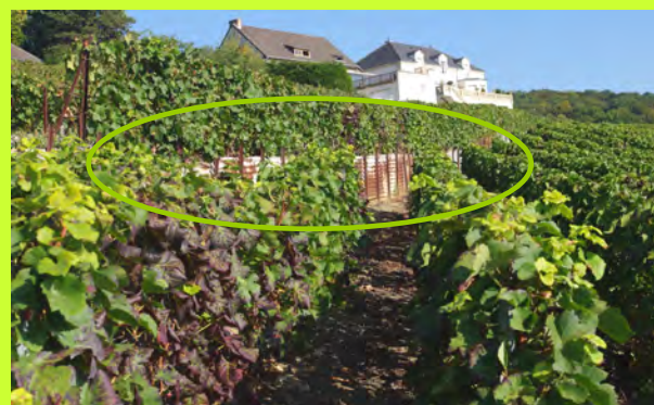
Les tôles de récupération comme élément de soutènement non qualitatif
