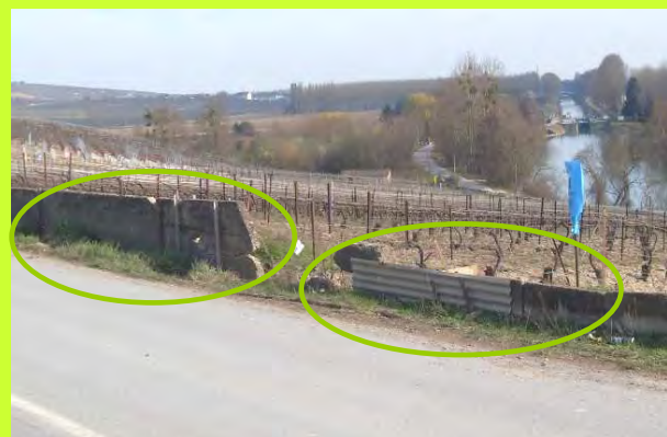
Des bordures de la D1 aménagées avec une juxtaposition de muret béton dégradé et de tôles ondulées rouillées détériorées
