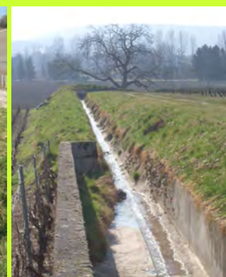
Fossé structuré par des murets de soutènement, aménagé en aval du fossé pour recevoir le cours d'eau dans la plaine
