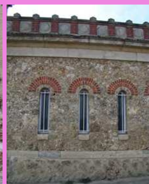
Utilisation de la pierre meulière avec des assemblages singuliers de brique et de pierre locale
