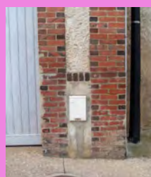
Intégrer les coffrets de manière harmonieuse aux parois et avec soin
