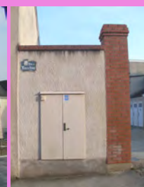
Armoire technique intégrée dans le mur de clôture
