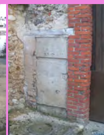
Emplacement pouvant accueillir un coffret
