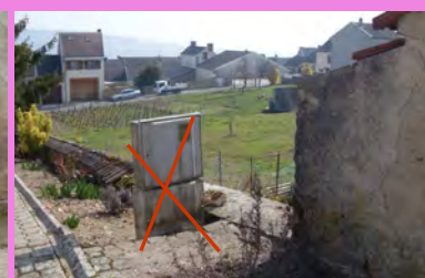
Eviter les coffrets, s'élevant sans support d'intégration (façade, muret...)
